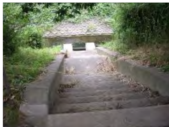
消防用水の取水施設
